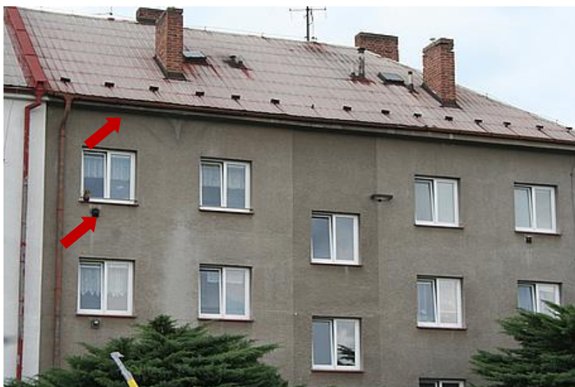
Obr. 11: Možnost úkrytu v podstřeší a v místech vyústění vafek
