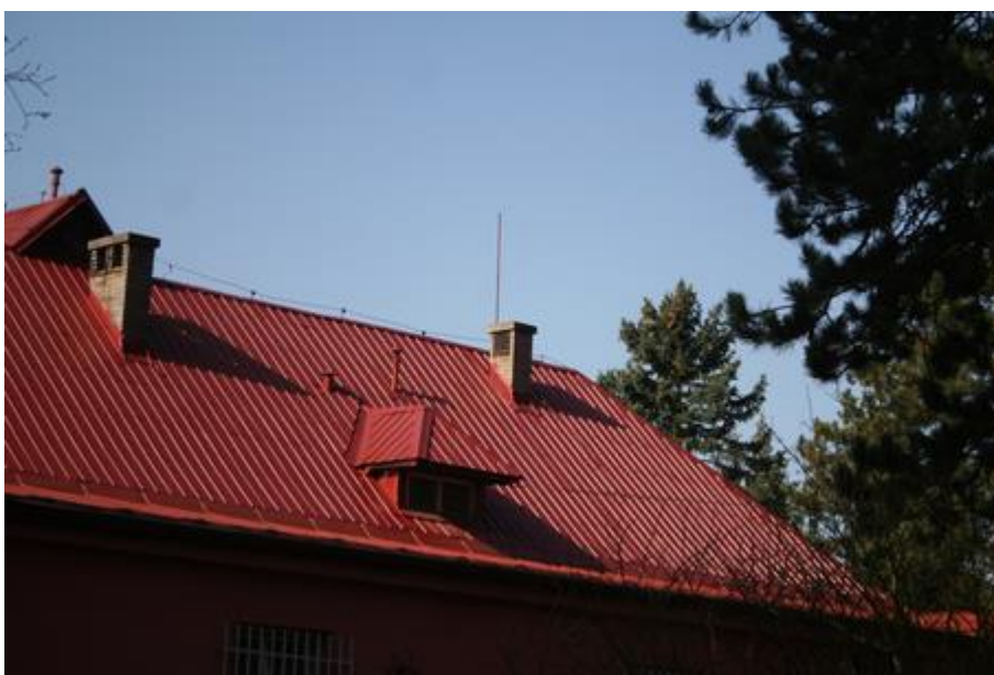
Obr. 10: V komínech je umístěná mřížka proti hnízdění kavek (areál psychiatrické léčebny)
