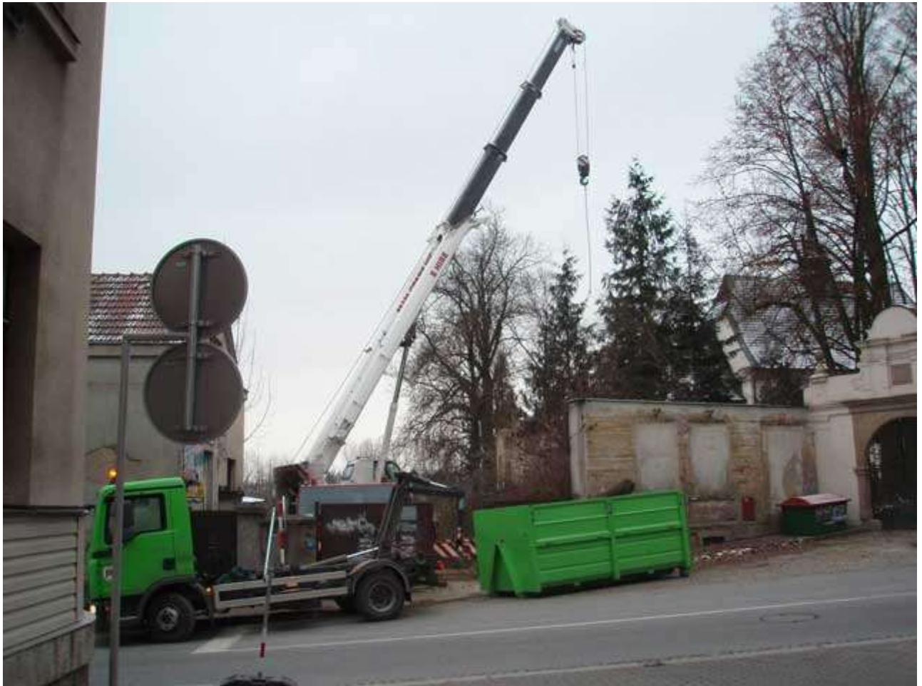
Kácení dřevin a nakládka dřevní hmoty ve ztížených podmínkách pomocí jeřábové techniky - dne 14.12.2009.
